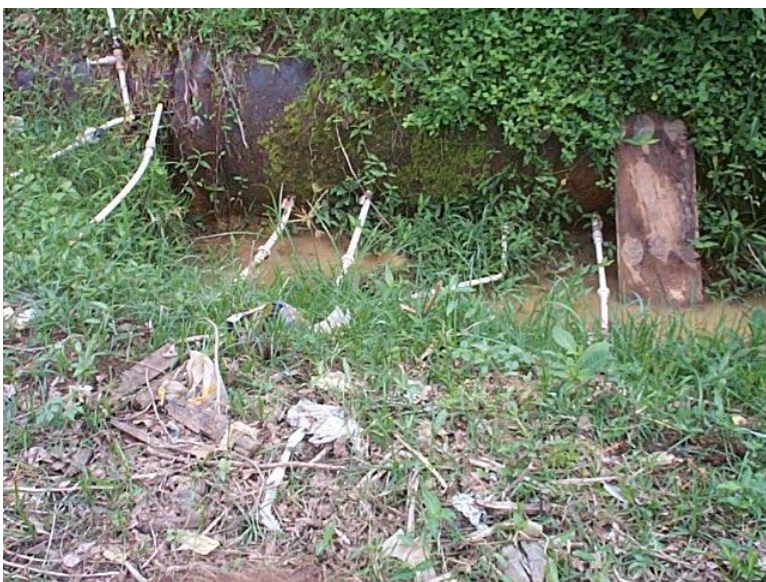
FLAGRANTE DE LIGAÇÕES CLANDESTINAS EM ADUTORA
