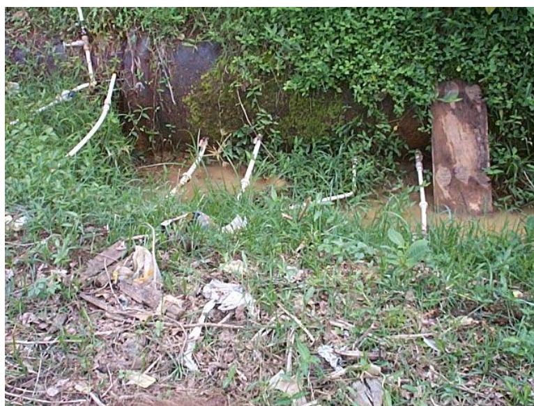
FLAGRANTE DE LIGAÇÕES CLANDESTINAS EM ADUTORA
