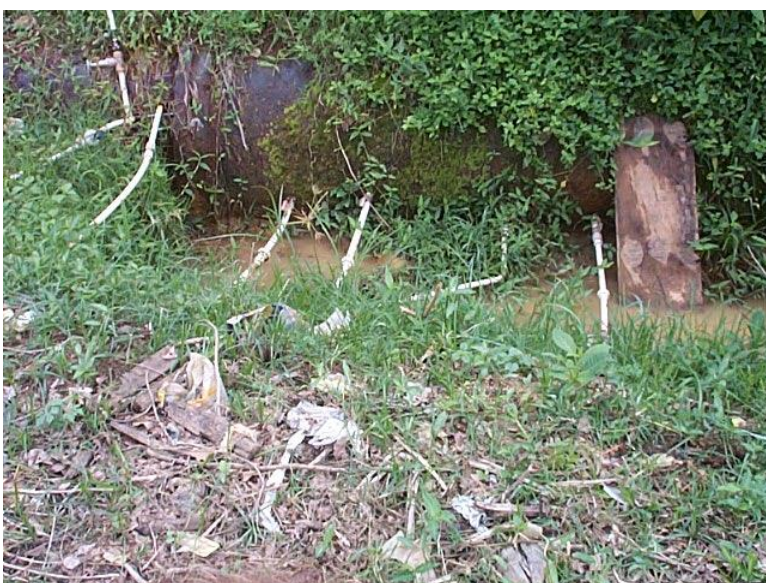
FLAGRANTE DE LIGAÇÕES CLANDESTINAS EM ADUTORA
