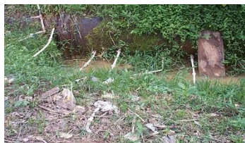
Flagrante de ligações clandestinas em adutora
