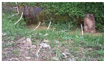
Flagrante de ligações clandestinas em adutora
