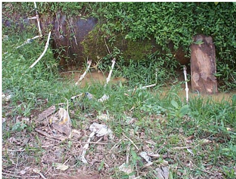
FLAGRANTE DE LIGAÇÕES CLANDESTINAS EM ADUTORA
