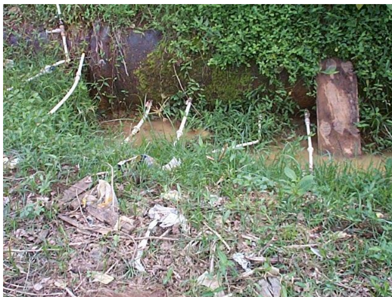
FLAGRANTE DE LIGAÇÕES CLANDESTINAS EM ADUTORA
