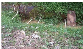
Flagrante de ligações clandestinas em adutora
