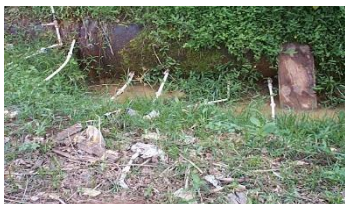
Flagrante de ligações clandestinas em adutora
