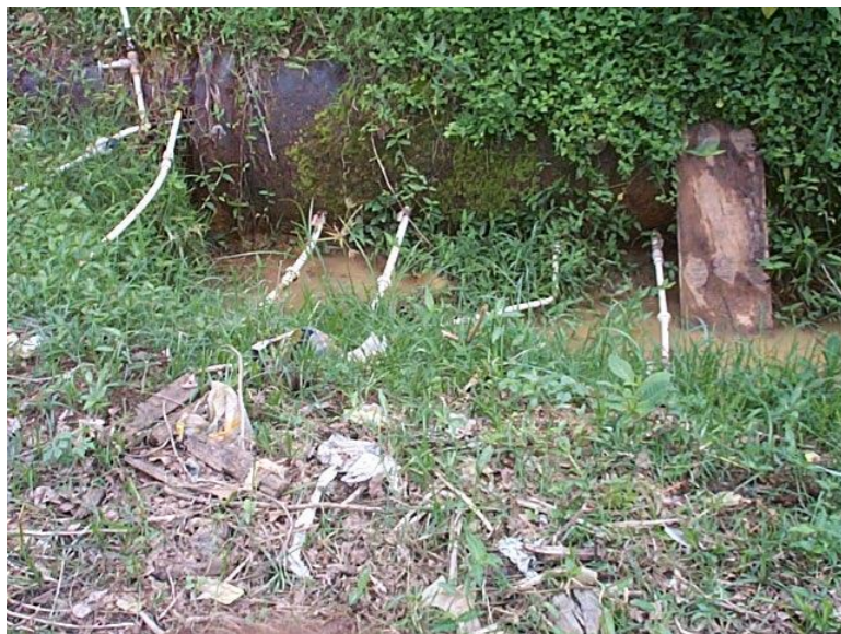
FLAGRANTE DE LIGAÇÕES CLANDESTINAS EM ADUTORA
