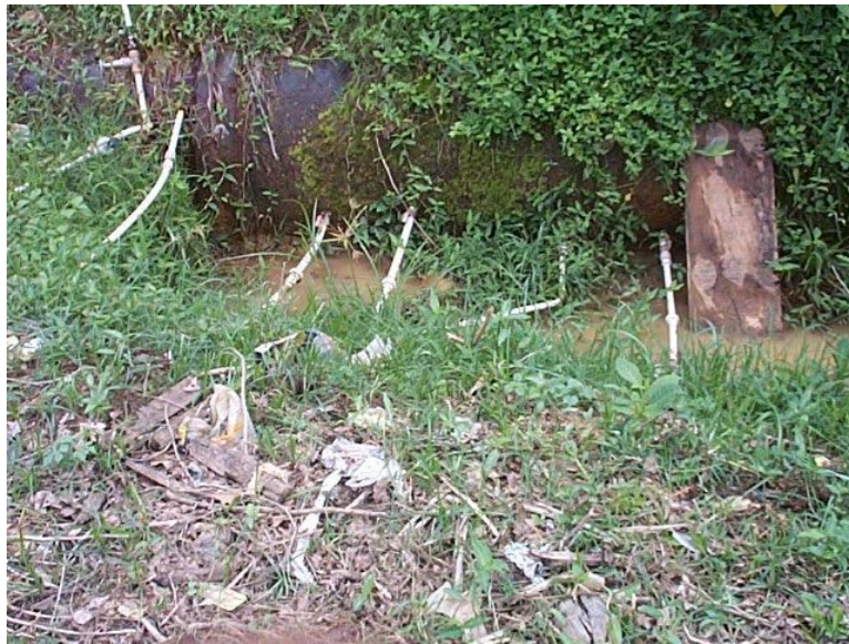
FLAGRANTE DE LIGAÇÕES CLANDESTINAS EM ADUTORA
