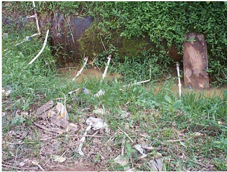
FLAGRANTE DE LIGAÇÕES CLANDESTINAS EM ADUTORA
