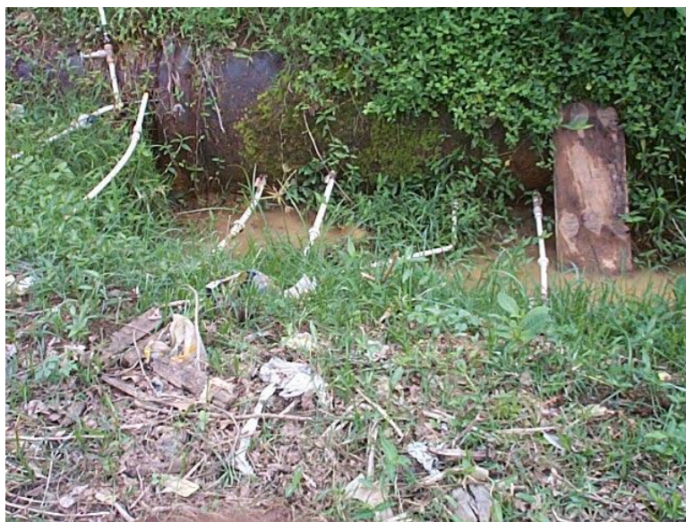
FLAGRANTE DE LIGAÇÕES CLANDESTINAS EM ADUTORA
