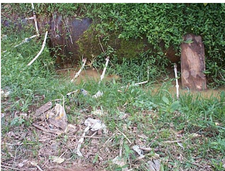
FLAGRANTE DE LIGAÇÕES CLANDESTINAS EM ADUTORA
