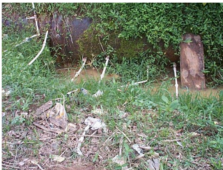
FLAGRANTE DE LIGAÇÕES CLANDESTINAS EM ADUTORA
