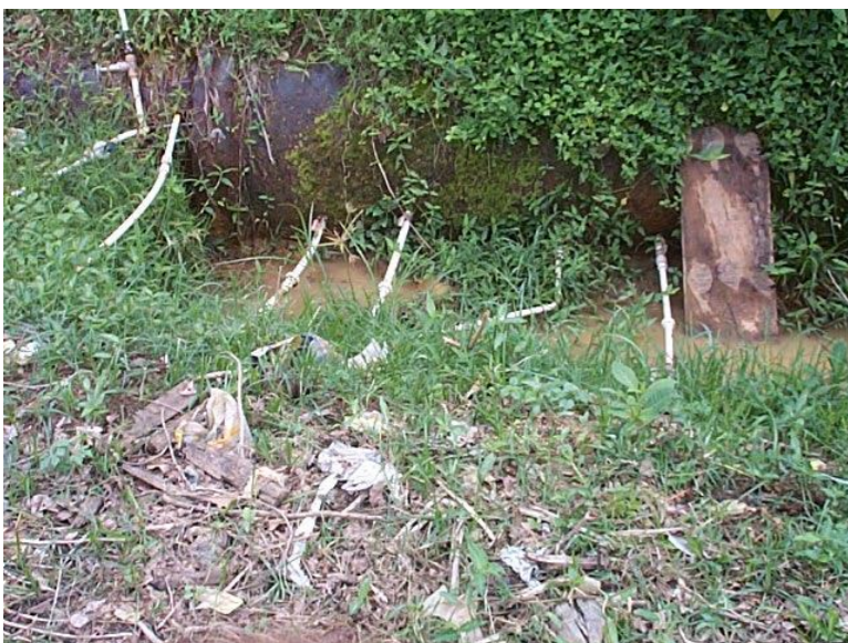
FLAGRANTE DE LIGAÇÕES CLANDESTINAS EM ADUTORA
