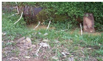
Flagrante de ligações clandestinas em adutora
