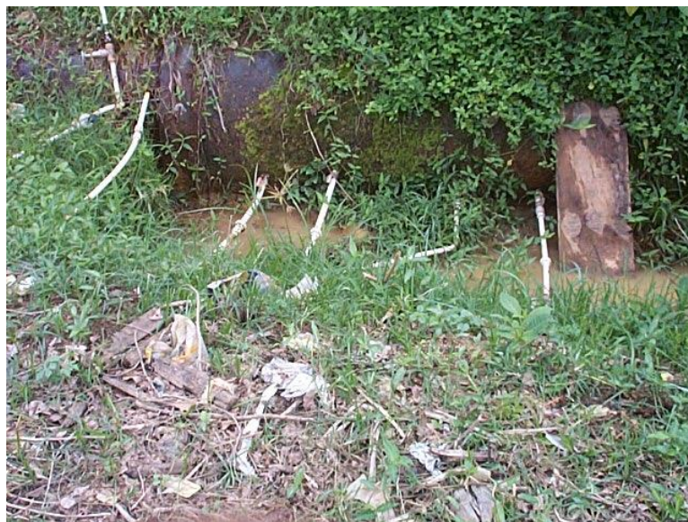
FLAGRANTE DE LIGAÇÕES CLANDESTINAS EM ADUTORA
