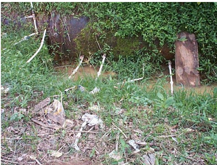
FLAGRANTE DE LIGAÇÕES CLANDESTINAS EM ADUTORA
