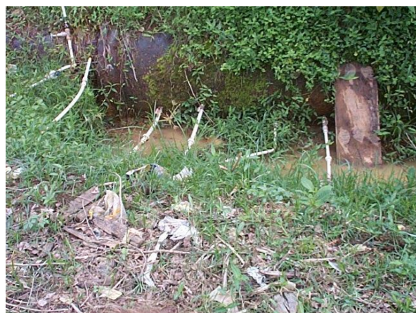
FLAGRANTE DE LIGAÇÕES CLANDESTINAS EM ADUTORA
