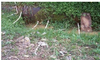
Flagrante de ligações clandestinas em adutora
