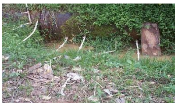
Flagrante de ligações clandestinas em adutora
