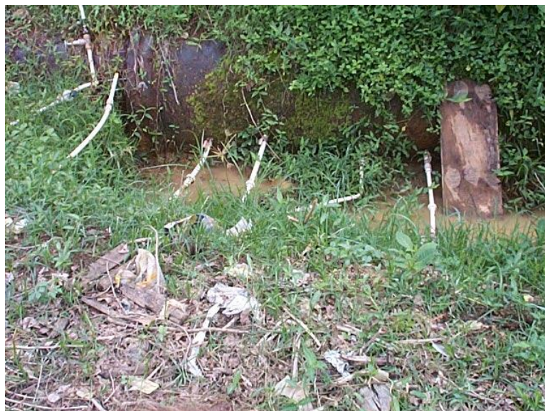
FLAGRANTE DE LIGAÇÕES CLANDESTINAS EM ADUTORA
