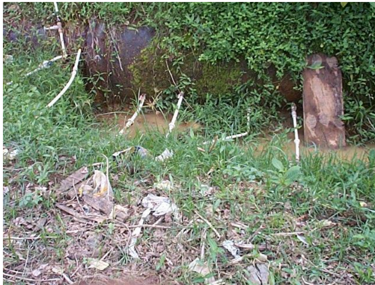
FLAGRANTE DE LIGAÇÕES CLANDESTINAS EM ADUTORA
