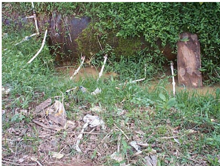
FLAGRANTE DE LIGAÇÕES CLANDESTINAS EM ADUTORA
