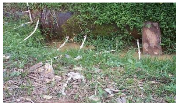
Flagrante de ligações clandestinas em adutora
