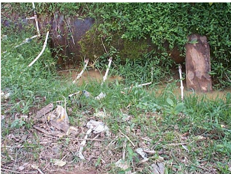
FLAGRANTE DE LIGAÇÕES CLANDESTINAS EM ADUTORA
