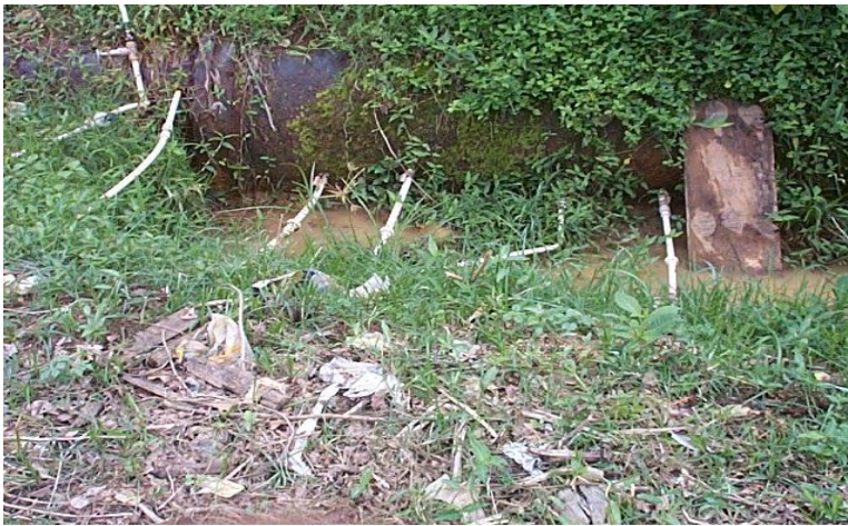
FLAGRANTE DE LIGAÇÕES CLANDESTINAS EM ADUTORA
