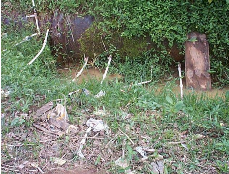
FLAGRANTE DE LIGAÇÕES CLANDESTINAS EM ADUTORA
