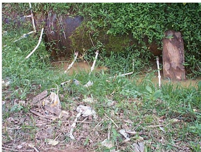
FLAGRANTE DE LIGAÇÕES CLANDESTINAS EM ADUTORA
