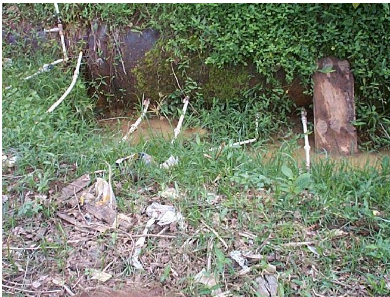
FLAGRANTE DE LIGAÇÕES CLANDESTINAS EM ADUTORA
