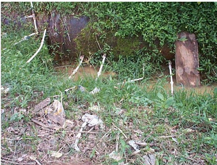
FLAGRANTE DE LIGAÇÕES CLANDESTINAS EM ADUTORA
