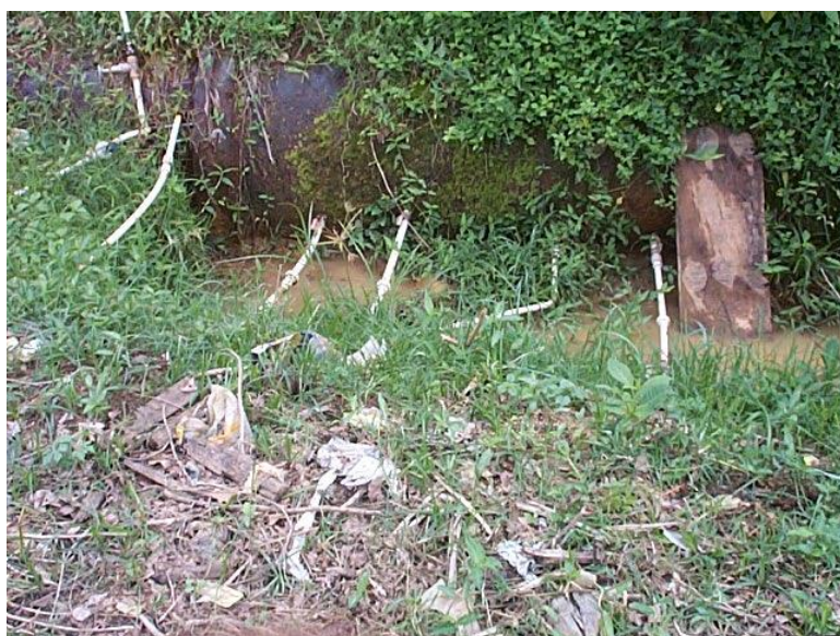
FLAGRANTE DE LIGAÇÕES CLANDESTINAS EM ADUTORA
