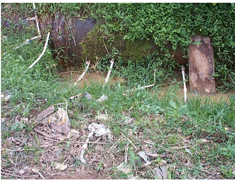
FLAGRANTE DE LIGAÇÕES CLANDESTINAS EM ADUTORA
