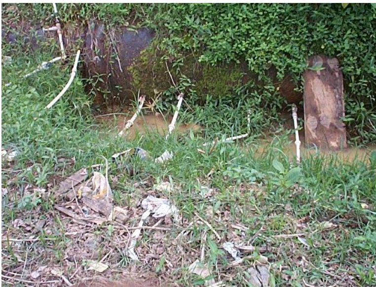
FLAGRANTE DE LIGAÇÕES CLANDESTINAS EM ADUTORA
