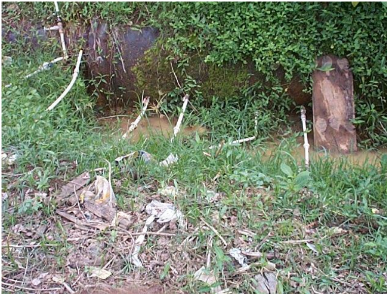
FLAGRANTE DE LIGAÇÕES CLANDESTINAS EM ADUTORA
