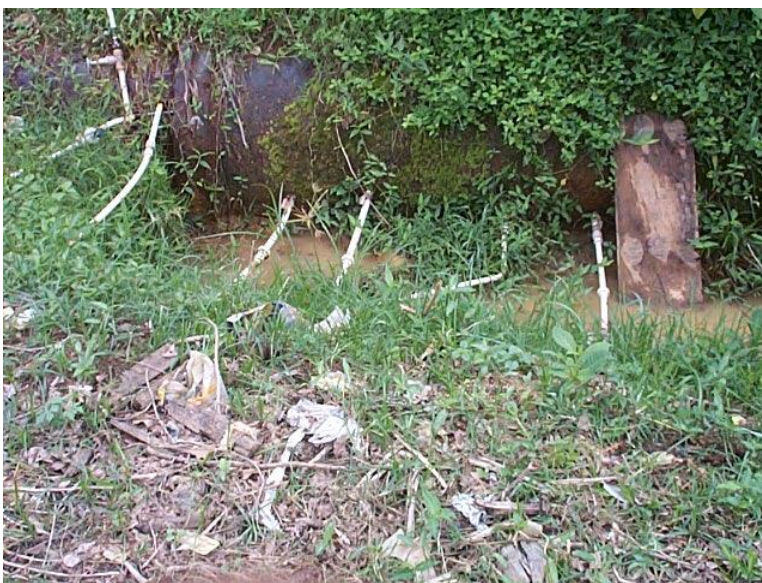
FLAGRANTE DE LIGAÇÕES CLANDESTINAS EM ADUTORA
