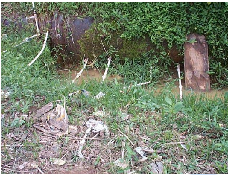
FLAGRANTE DE LIGAÇÕES CLANDESTINAS EM ADUTORA
