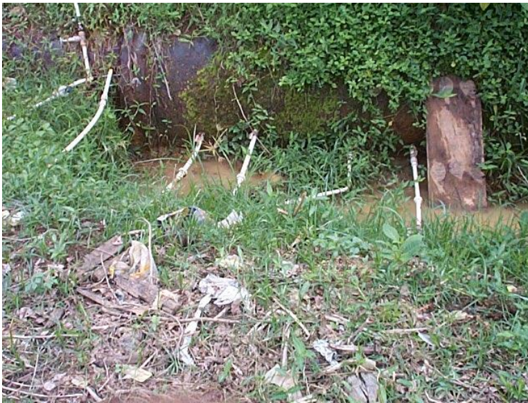
FLAGRANTE DE LIGAÇÕES CLANDESTINAS EM ADUTORA
