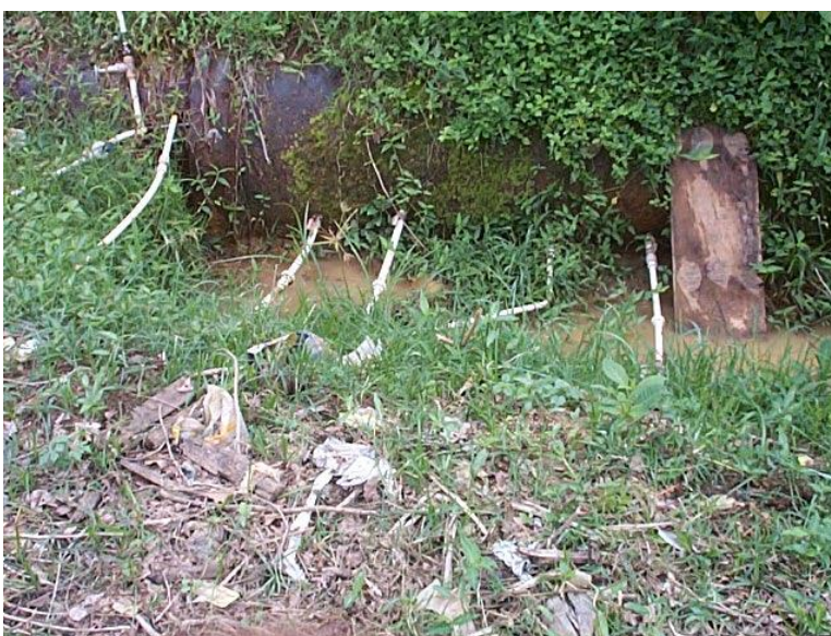
FLAGRANTE DE LIGAÇÕES CLANDESTINAS EM ADUTORA
