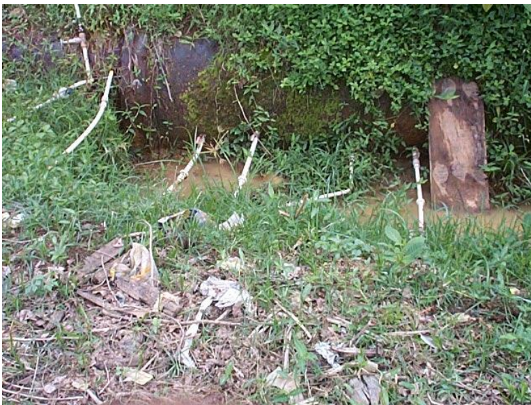
FLAGRANTE DE LIGAÇÕES CLANDESTINAS EM ADUTORA
