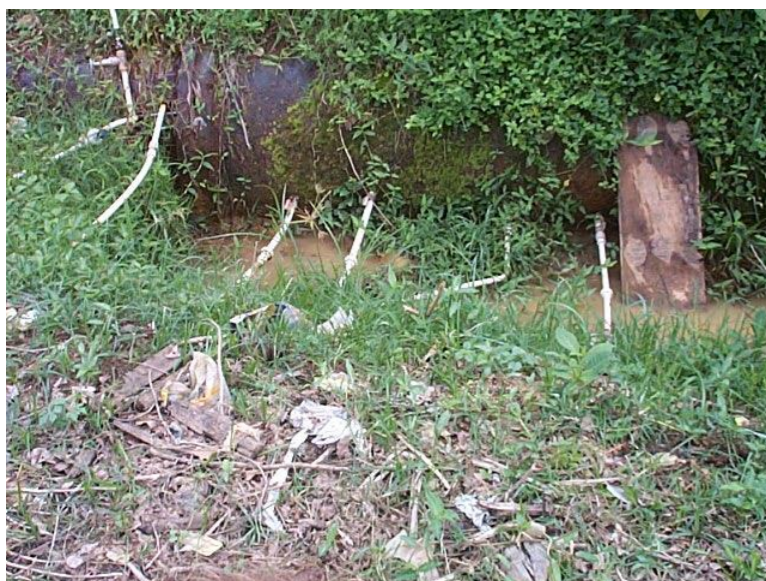
FLAGRANTE DE LIGAÇÕES CLANDESTINAS EM ADUTORA
