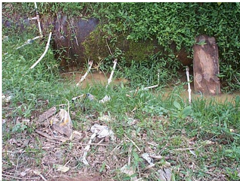
FLAGRANTE DE LIGAÇÕES CLANDESTINAS EM ADUTORA
