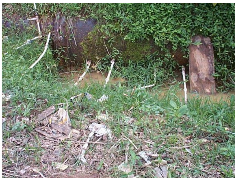
FLAGRANTE DE LIGAÇÕES CLANDESTINAS EM ADUTORA
