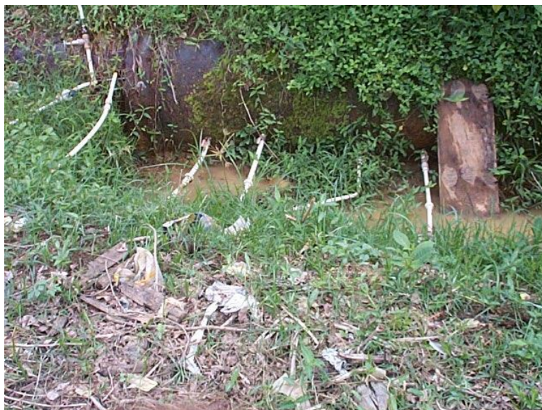
FLAGRANTE DE LIGAÇÕES CLANDESTINAS EM ADUTORA
