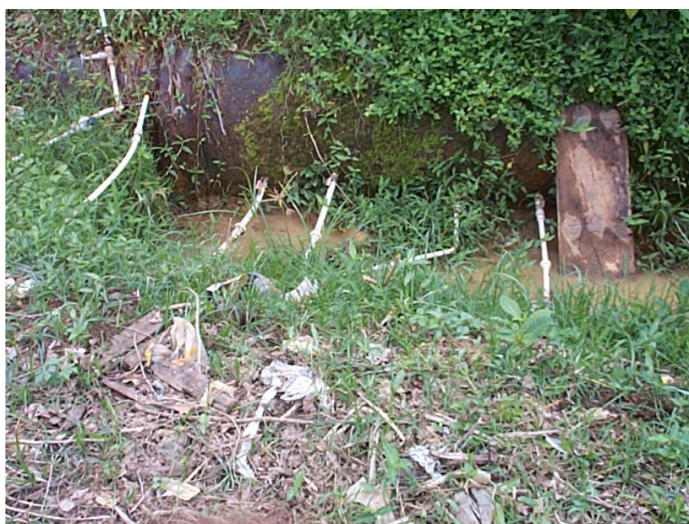
FLAGRANTE DE LIGAÇÕES CLANDESTINAS EM ADUTORA
