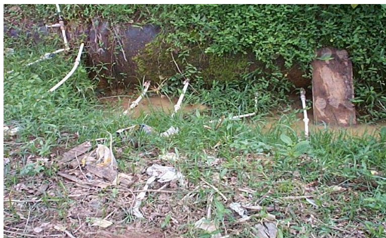
FLAGRANTE DE LIGAÇÕES CLANDESTINAS EM ADUTORA
