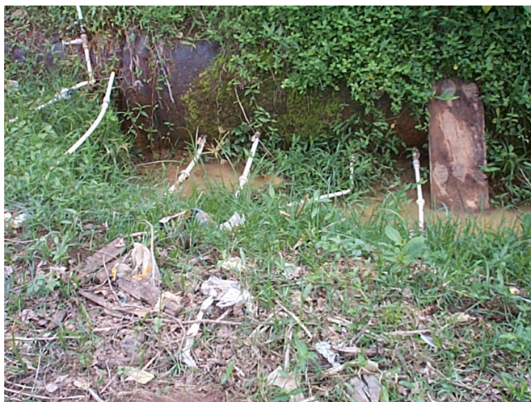
FLAGRANTE DE LIGAÇÕES CLANDESTINAS EM ADUTORA
