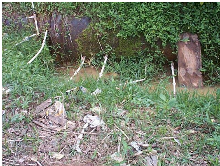
FLAGRANTE DE LIGAÇÕES CLANDESTINAS EM ADUTORA
