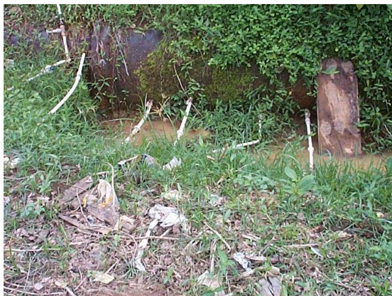
FLAGRANTE DE LIGAÇÕES CLANDESTINAS EM ADUTORA
